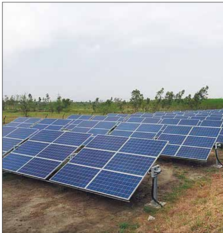
Placas solares. / FHMURCIA
